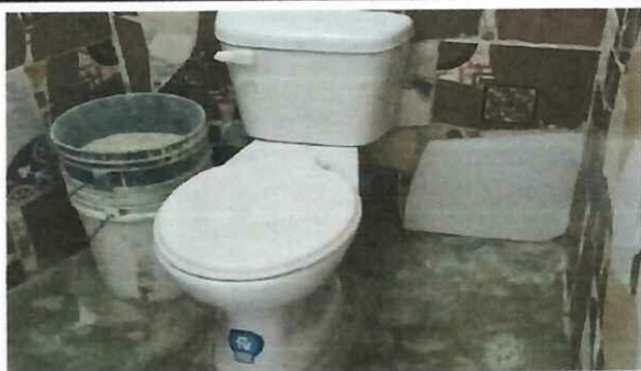
Foto 3: Los servicios sanitarios poseen problemas en tuberías por lo que es necesario hacer el cambio de tuberías correspondiente.
