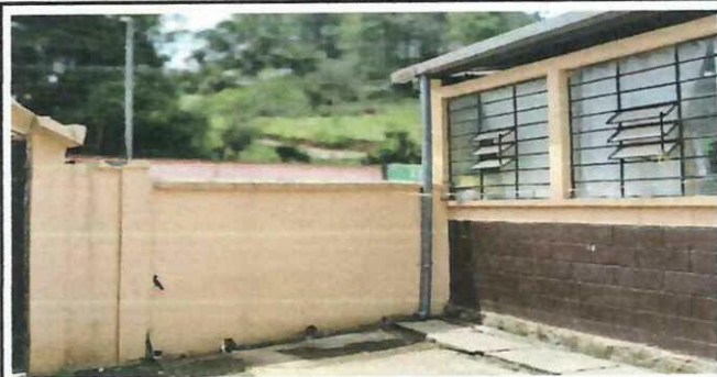
Foto 1: Piso de concreto entrada principal se encuentra dañada, necesita ser remozada para que los niños encuentren un ambiente agradable al momento de su entrada al establecimiento.
