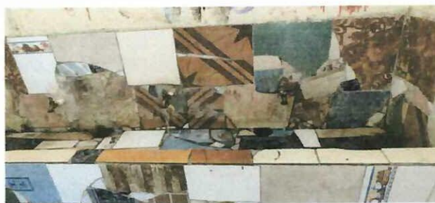
Foto 4: Se debe sustituir los azulejos en migitorios ya que los actuales ya se han deteriorado por su uso.
