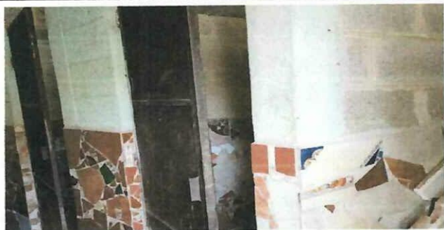
Foto 5: La paredes internas de baños y area de bodega se encuentran a block visto, por lo que es necesario un repello interior para que los niños y niñas encuentren un ambiente más agradable al momento de hacer uso de ellos.
